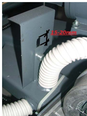
Положение направляющей воздушной заслонки системы безопасности
